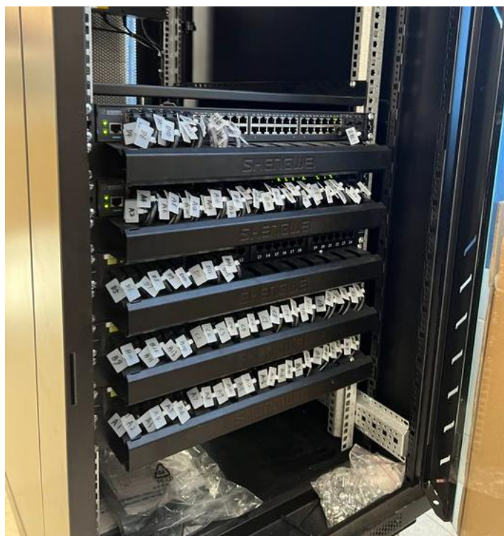
实训室网络机柜
